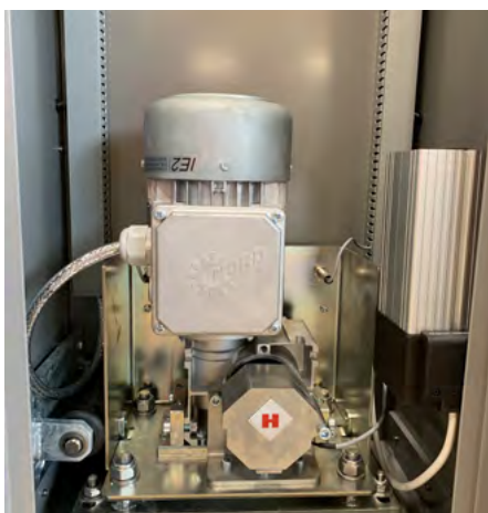
Motorisering Sleipner samt värme element.
